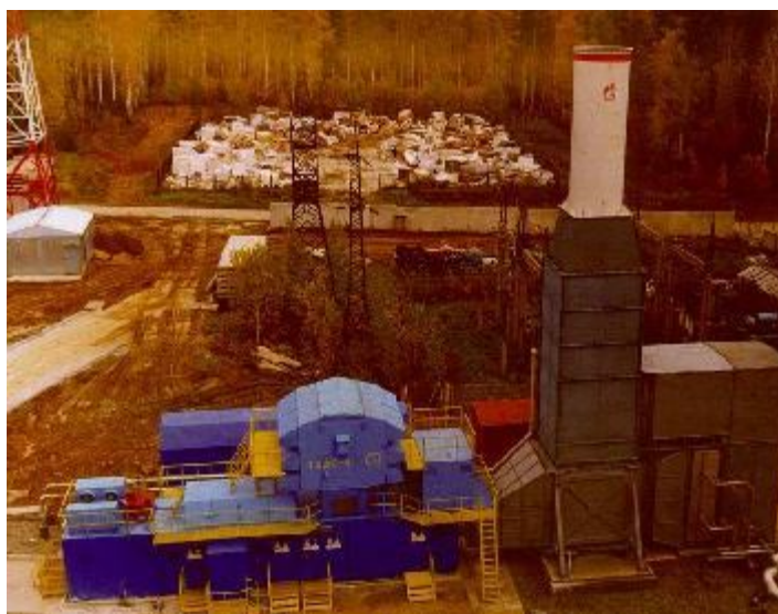
Рисунок 3 – ГТЭС-4000, разработчик ОАО «НПО Искра»
